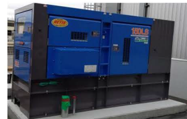
＜非常用電源設備＞
